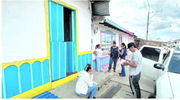
Equipo interdisciplinario de la Gobernación del Valle acompaña a los municipios en la inspección de viviendas afectadas por el sismo y sus réplicas.
