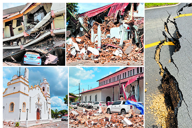
El terremoto que sacudió Panamá dejó edificaciones colapsadas, daños en iglesias y vías agrietadas.
