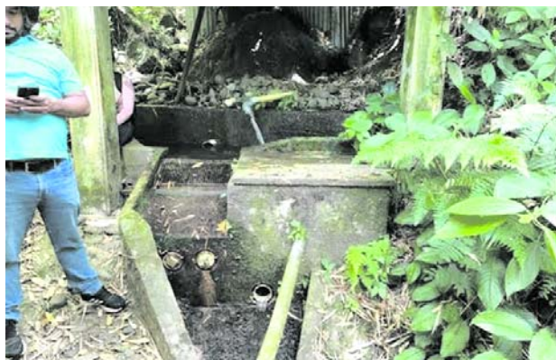
Más de 73 acueductos rurales resultaron afectados por el sismo.
