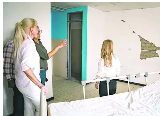
La gobernadora Dilian Francisca Toro y la ministra de Transporte, Elsa Noguera, verificaron las afectaciones ocasionadas por el terremoto en municipios del norte del Valle.
