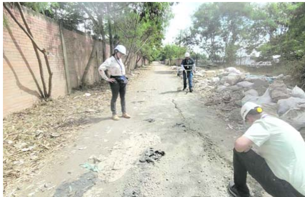
La CVC y la Pontificia Universidad Javeriana Cali inspeccionaron cinco sectores del jarillón del río Cauca tras el sismo del 10 de agosto.
