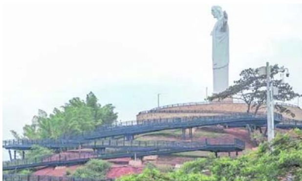
Ecoparque Cristo Rey registra daños en estructuras, losas y monumento tras el terremoto del 10 de agosto.
