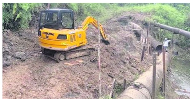
Con maquinaria amarilla se busca solucionar lo más pronto posible las dificultades de abastecimiento de agua en Buenaventura
