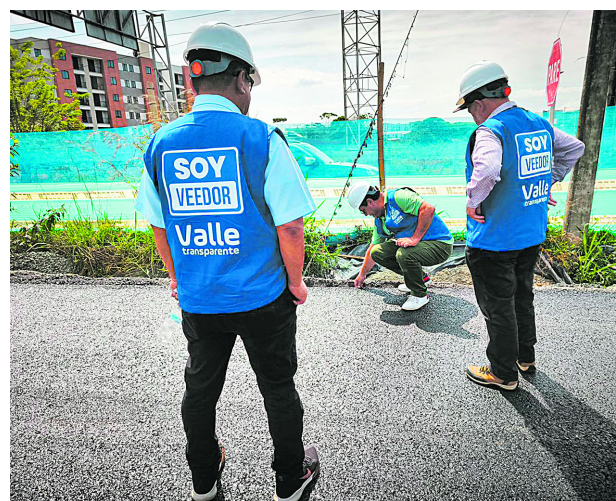
Los veedores ciudadanos realizan acompañamiento permanente al desarrollo de la obra y verifican el cumplimiento de los compromisos adquiridos con la comunidad.
