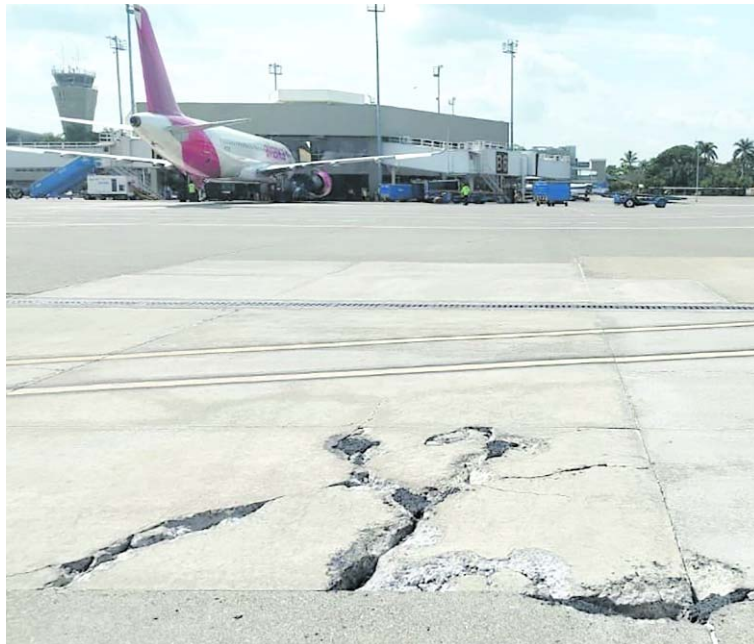
Imágenes difundidas en redes sociales muestran fisuras en la infraestructura del aeropuerto Alfonso Bonilla Aragón en Cali.
