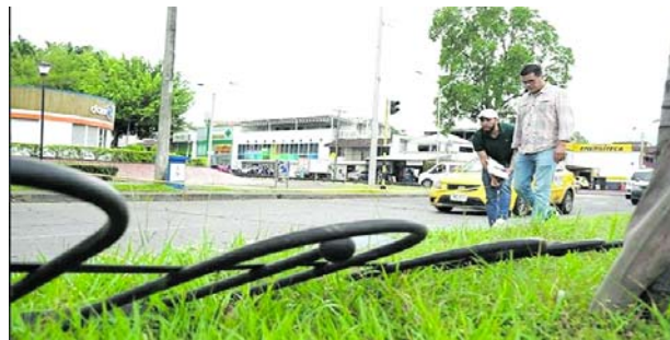
Reparan separadores viales tras hurto de rejas metálicas en varias zonas de Cali.
