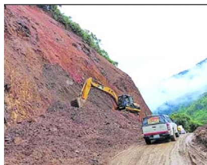
Hay alerta en Risaralda por posibles derrumbes ante la continuidad de las lluvias.
